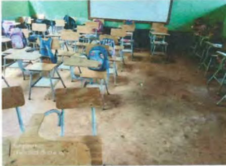
Foto 3: Se observa la torta de las aulas en mal estado.
