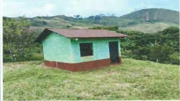
Foto 4: Se observa las laminas portantes de la cocina en mal estado.
