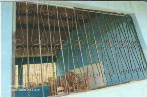
Foto 5: Se observa el desprendimiento de pintura en los balcones.
