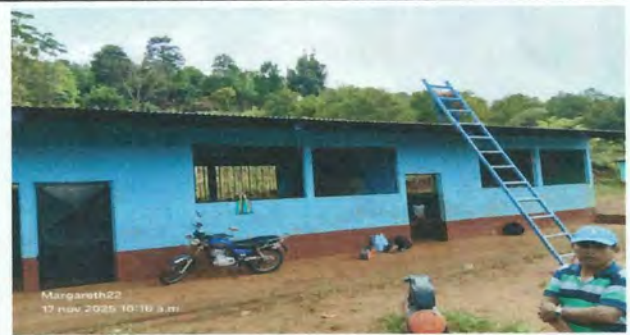
Foto : Se observa la pintura en mal estado en la pared de las aulas.
