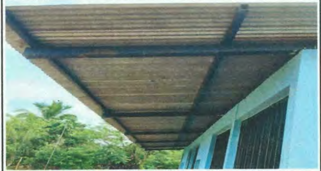
Foto 2: Se observa las estructura portante con desprendimiento de pintura
